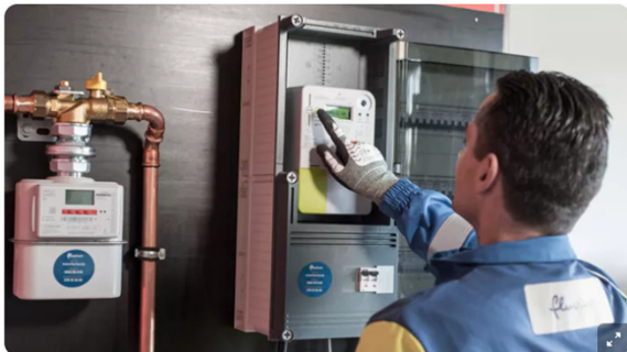
Fluvius kan de installatie van de digitale meters nu opleggen.
